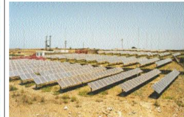
PV-System mit 100 kWp
